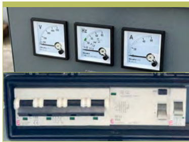
INSTRUMENTS AND BREAKERS STRUMENTI E INTERRUTTORI
